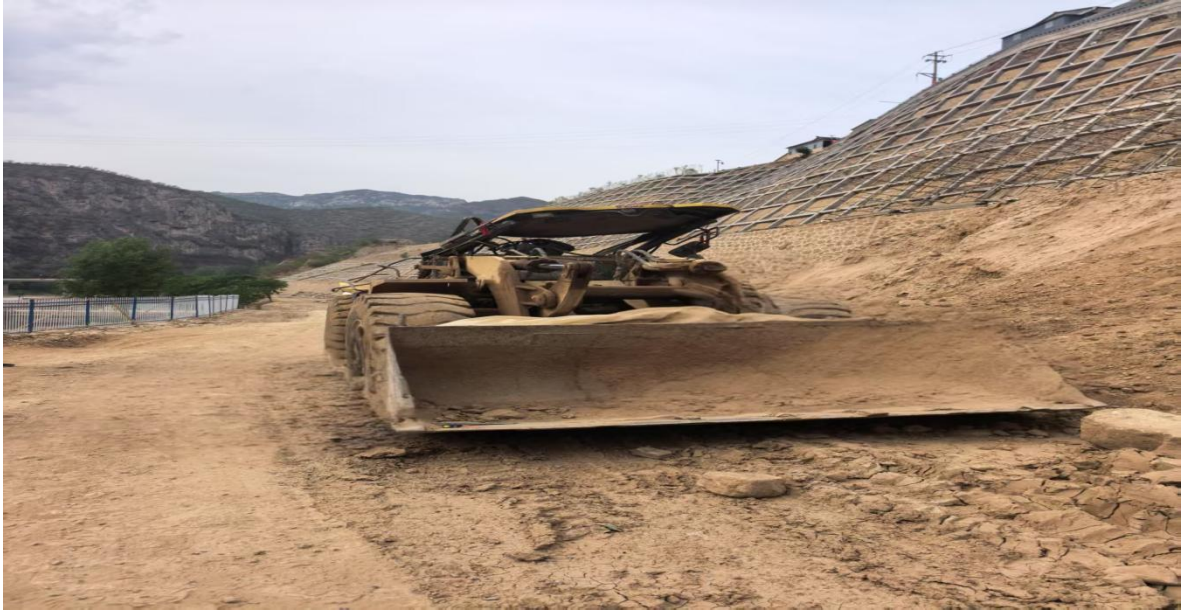
图片 2 事故现场装载机及死者受伤位置图
